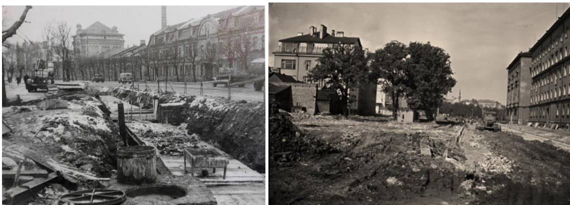
Joonis 1.3. Vasakul – Tallinna esimese soojusmagistraali rajamine Mere puiseteele (1956–1959) (allikas: Utilitase arhiiv); paremal – soojusmagistraali rajamine Lomonossovi (praegu Gonsiori) tänavale (allikas: Tallinna Linnamuuseum, TLM Fn 6582:31)
