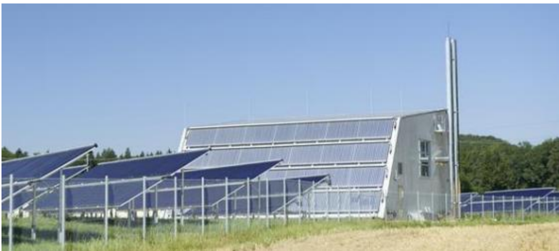
Joonis 2.10. Päiksekollektorid ja biomassi katlamaja Büsingenis (allikas: https://www.solarcomplex.de/ )
